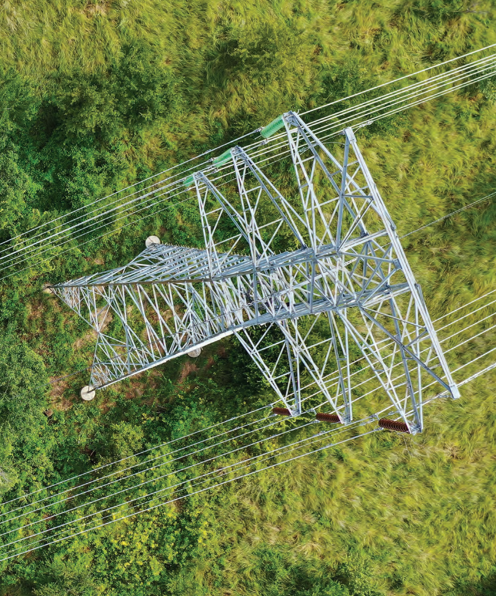
GHANA: Projet de réhabilitation et de construction de lignes de transport d'électricité par GRIDCo. Signé le 18/11/2022
